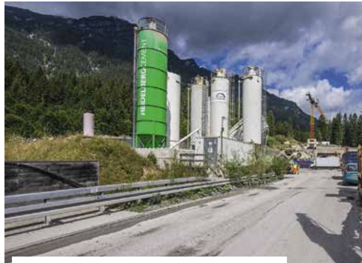
Blick auf die Mischanlage vor dem Eingang des Südportals
