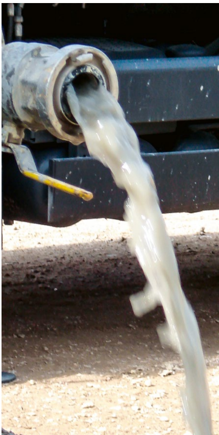
Refoulement d'eau du trou de forage.
