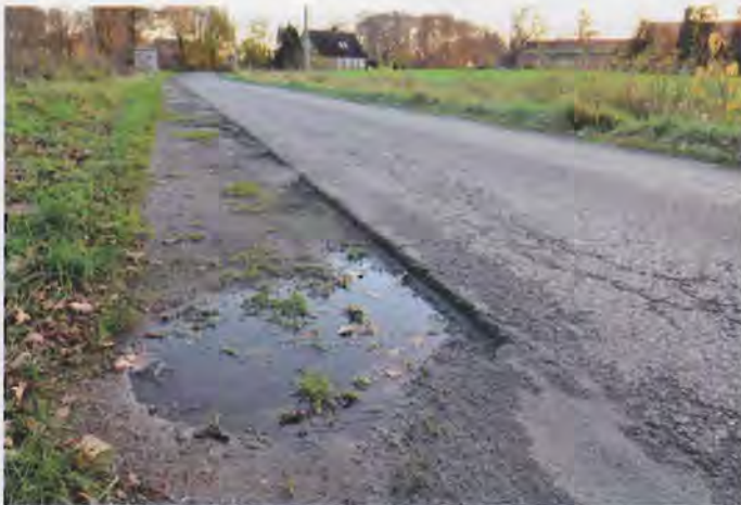
Bild 1: Zustand der Bankette „Im Aatal“ vor der Instandsetzung
