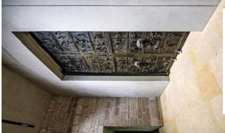
Im Zuge der Domsanierung wurde die mittelalterliche Bernwardstür weiter nach innen verlegt. Eine Wand aus Sichtbeton umrahmt nun die zweiflügelige Bronzetür.
