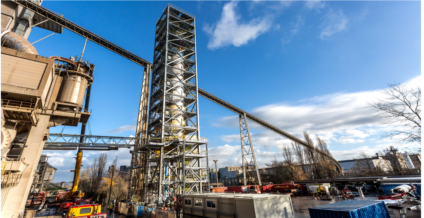
↑ CO 2 -Abscheidung mit Leilac-Verfahren im Zementwerk Lixhe, Belgien.
