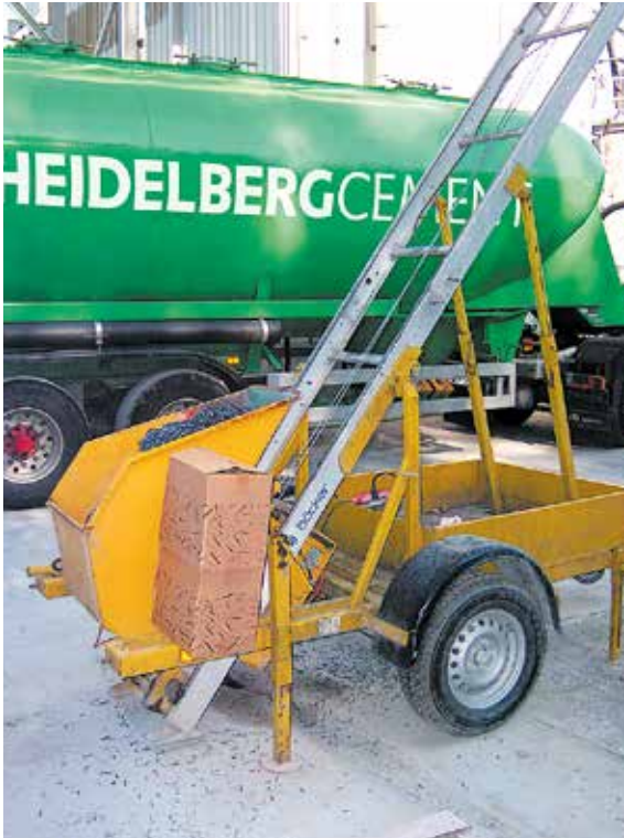
↑ Bild 32 a: Aufzug zur Zugabe von Stahlfasern in den Mischer
