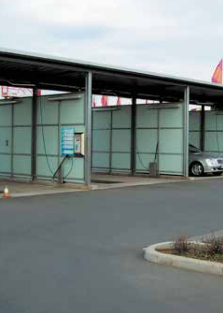
↑ Bild 20: Fahrzeugwaschplätze ausgeführt in Steelcrete
