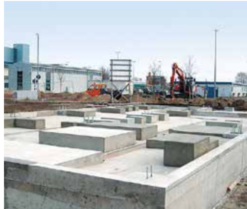
↑ Bild 21: Biodieselanlage – Auffangwanne mit Fundamenten für ein Tanklager ausgeführt in Steelcrete
