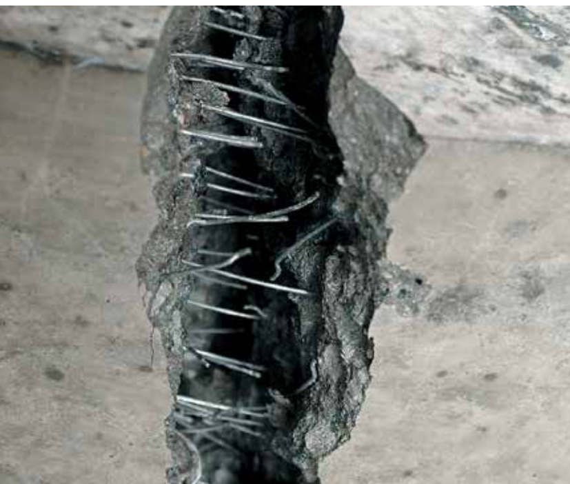
← Bild 2: Aufgebrochener Stahlfaserbeton
